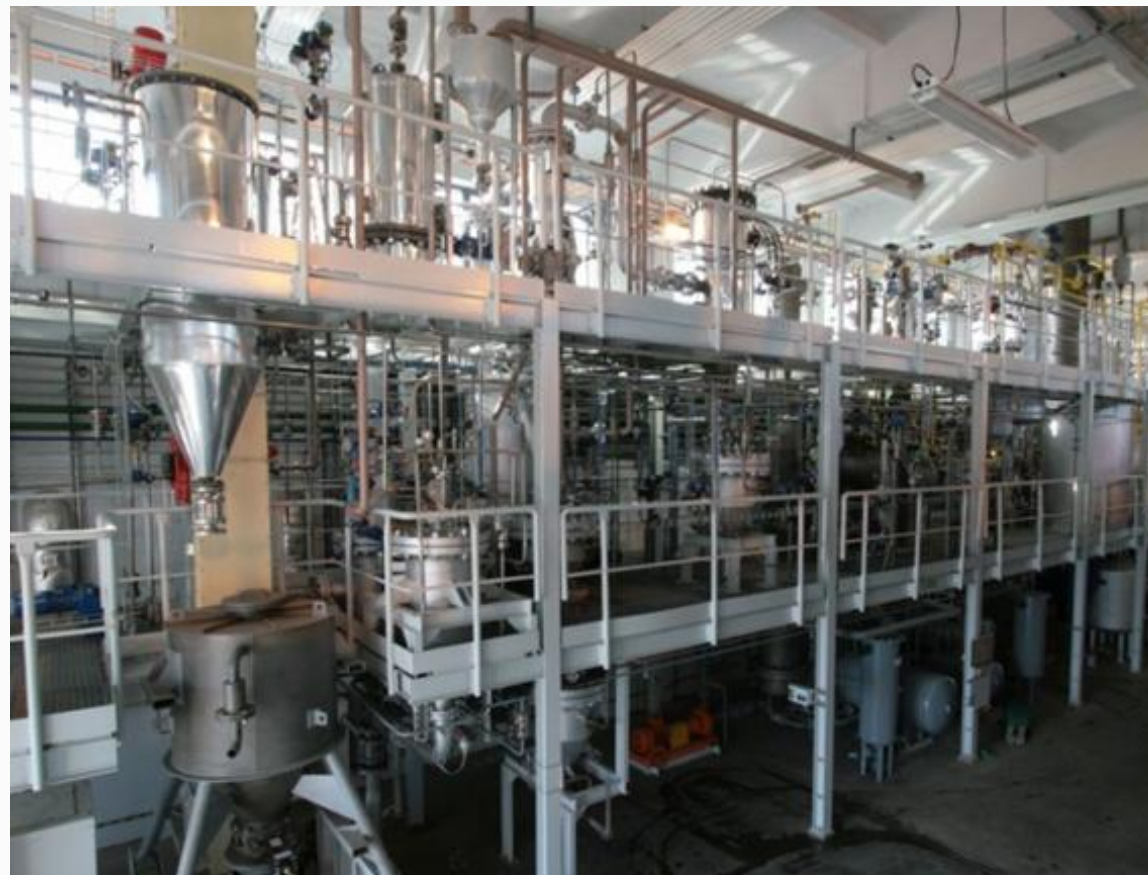
Instalacja zgazowania i oksyspalania paliw stałych w ciśnieniowym reaktorze z cyrkulującym złożem fluidalnym
