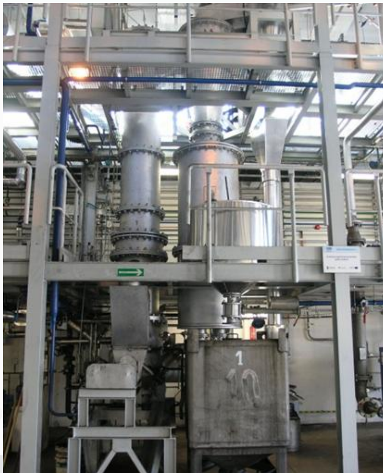
Instalacja zgazowania/pirolizy paliw stałych
