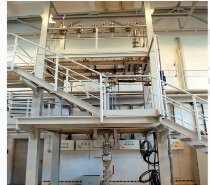
Instalacja zgazowania węgla ze złożem przesuwным
